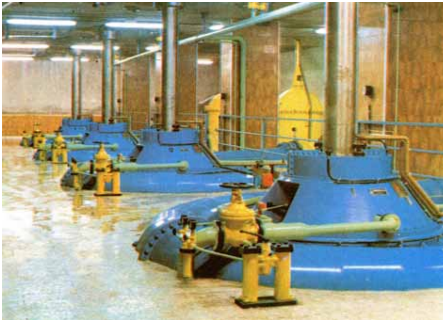
Foto 6. Impulsión de Ojós.
